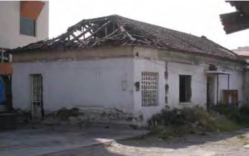
Los procesos de especulación inmobiliaria dan mayor valor económico al terreno en sí, que a las edificaciones. El abandono es el inicio para su destrucción y posterior derrocamiento. Calle Ulpiano Páez, entre Veintimilla y Cordero (RAD). 2010.
