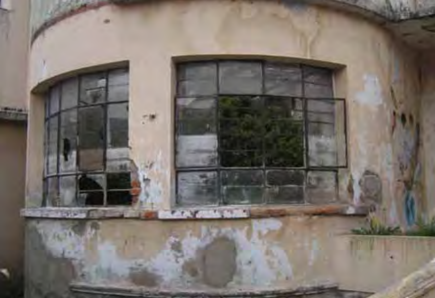
Vivienda abandonada en la calle General Baquedano y avenida 6 de Diciembre, en franco proceso de deterioro. La maleza a ingresado al interior de la edificación, se convertirá en ruina y en pocos meses deberá ser derrocada (RAD) 2010.
